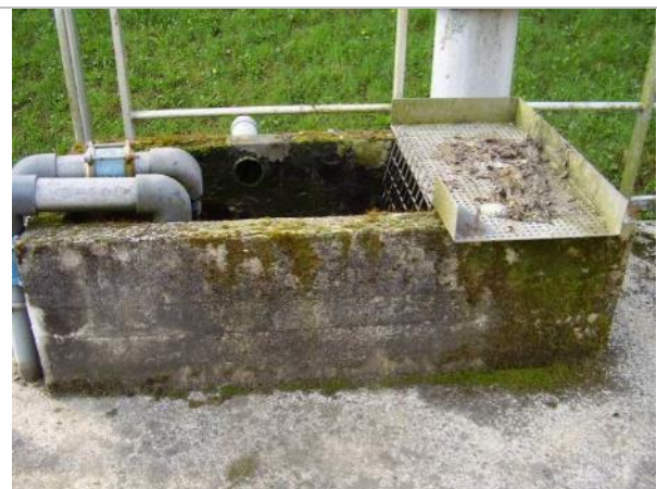
Arrivée des effluents, dégrilleur manuel
