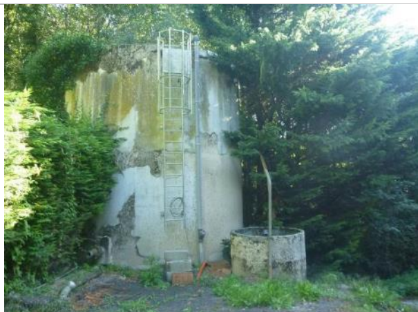
Silo à boues et PR
